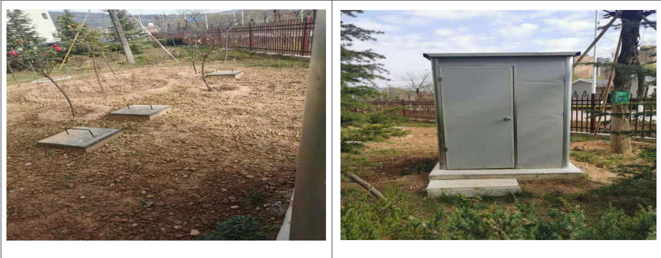
地埋式污水处理站
